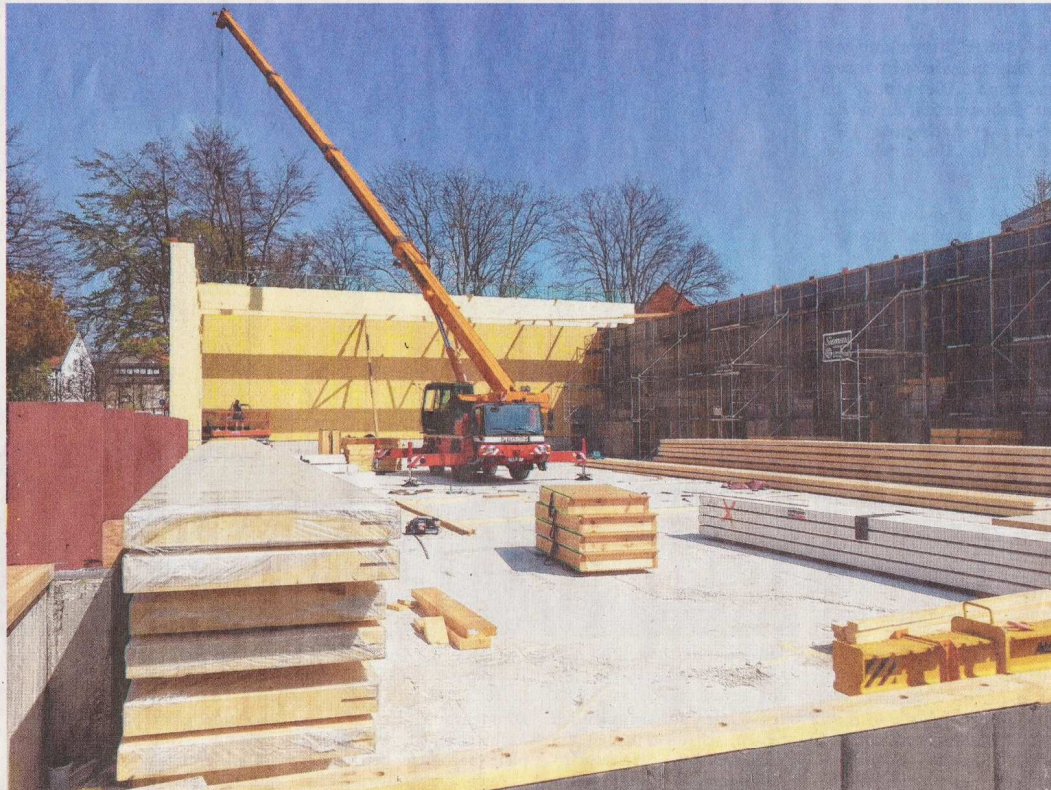
Nimmt Formen an: Der Bau der neuen Turnhalle des Engelbert-Kaempfer-Gymnasiums zwischen Schule und dem Parkhaus „Wüste“ ist in vollem Gange.
